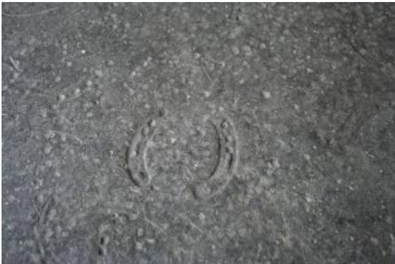
Figur 31. Löpgångar i kliniker och hovslagerier bör ha fast men halkfritt golv. Ett bra material är gummi-asfalt, alltså en blandning av just gummi och asfalt. Materialet är plastiskt och just där (ledda) hästar står ofta eller vänder är ett annat mer formfast golvmaterial att föredra.
